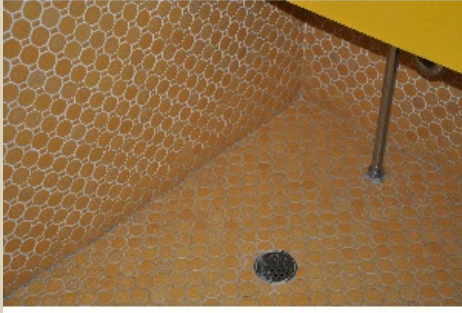
Asbestos Flooring - Tiles-6.jpg
