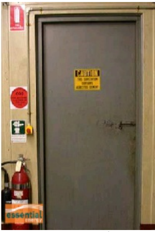
Substation Fire Doors 1.jpg
